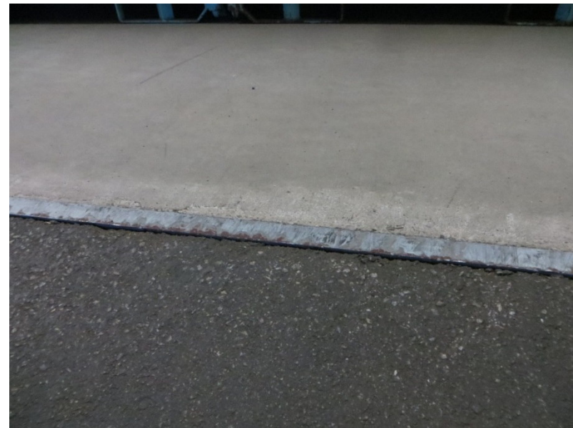
Die feuerverzinkte Korrosionsschutzschicht auf dem Stahlwinkel ist durch „Einschläge“ bereits stark angegriffen, der Winkel ist nicht mehr unfallsicher fixiert
